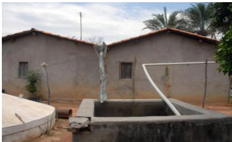
Figura 8: Cisterna de 52 mil litros adaptada para roça. Fonte: Google imagens
