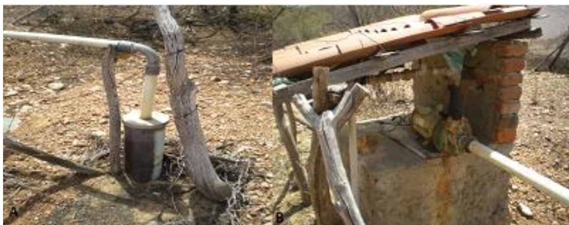
Figura 2: A - Detalhe do poço artesiano e B - Eletrobomba, instalados na comunidade
