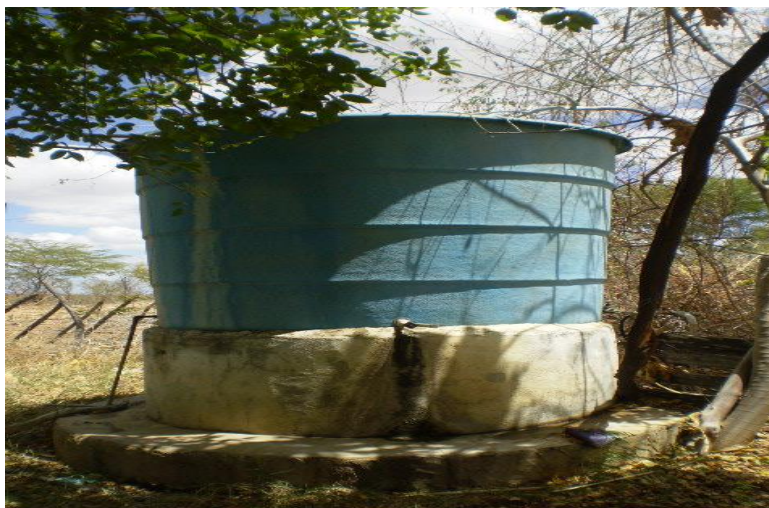
Figura 3: Detalhe de caixa que recebe água bombeada para distribuição Fonte: Josimar A. de Medeiros, set./2013.
