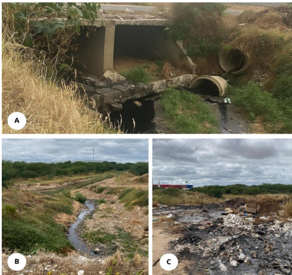
Figura 06 - Riacho Porteiras. (A – C) despejo de esgoto e lixo em trecho urbano do riacho, nas proximidades do Mix Mateus, Bairro Cohab Massangano, Petrolina- PE
