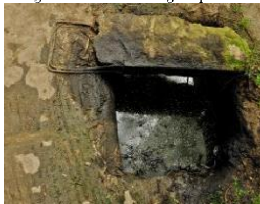
Figura 2- Galerias de águas pluviais
