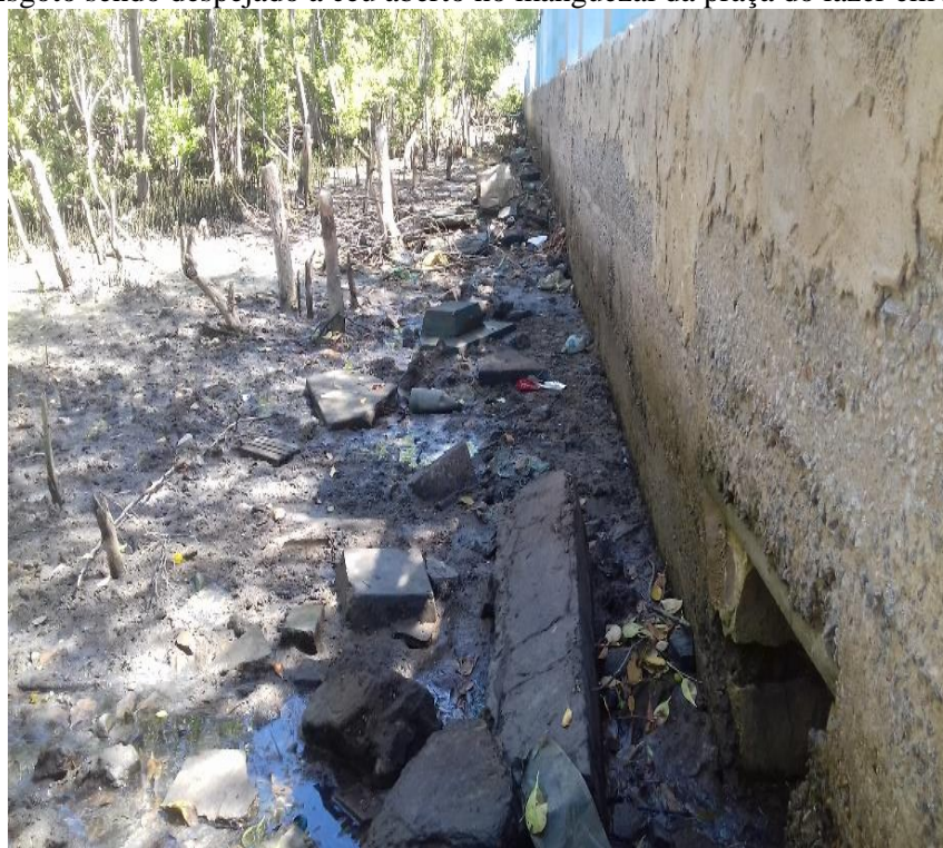
Figura 5: Esgoto sendo despejado a céu aberto no manguezal da praça do lazer em Macau (RN).
